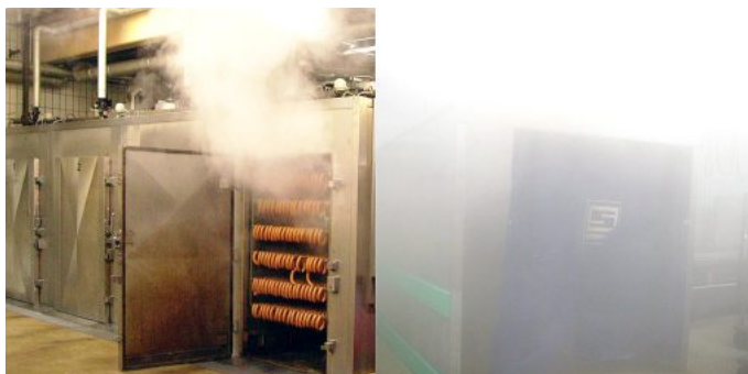
Austretende Schwaden erzeugen auch einen hohen Feuchteeintrag.
